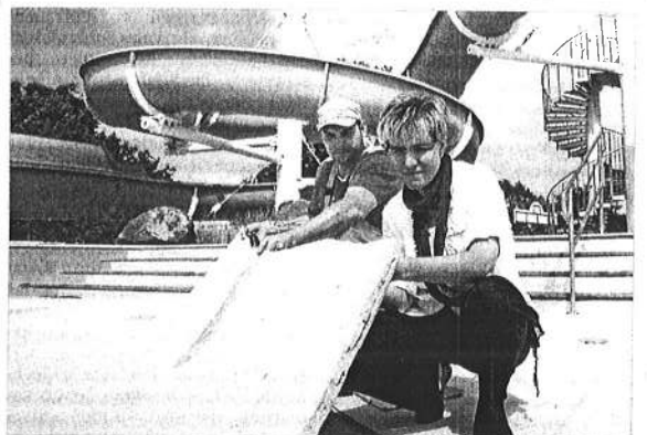
Total kaputt: Bürgermeisterin Anita Maaß und Schwimmmeister Ronny Striegler-Valley zeigen die Schäden am Schwimmbecken des Terence-Hill-Freibades Lommatzsch.
